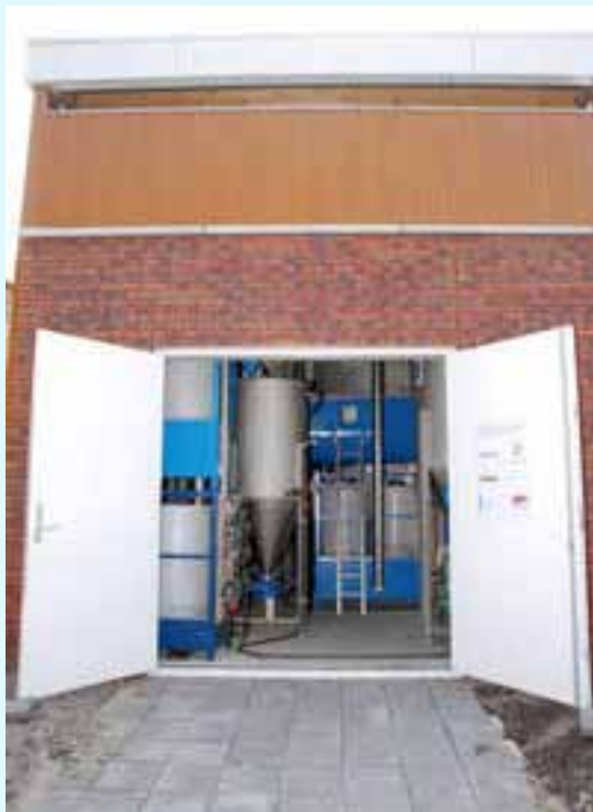
Garage met decentrale zuiveringsinstallatie, Sneek Producent: Landustrie
